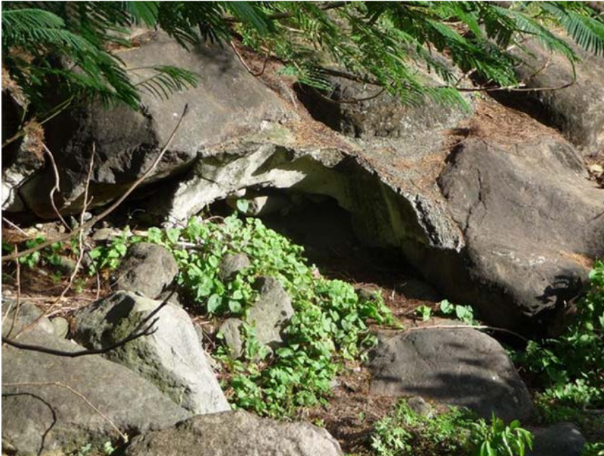
Photo : Enrochement liaisonné déstabilisé à Basse-Terre sur la rivière aux Herbes
